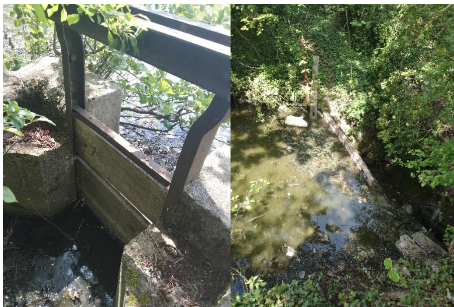
Body č. 79 a 80 – Nevyhovující technický stav výpustního objektu rybníku v Poboří
