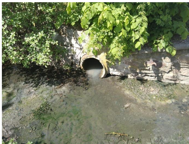
Bod č. 84 – Vyústění se znečištěním
