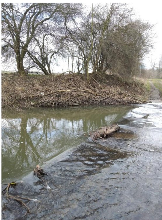
Bod č. 27 – překážka v průtočném profilu
