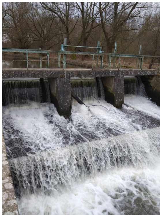
Bod č. 4 – splav (ř. km 22,96), kmen v prostředním poli, podemletá zeď
